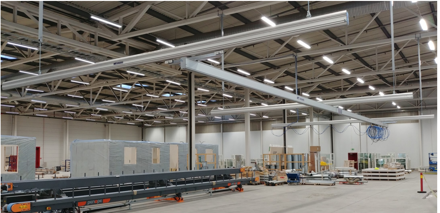
Skensystem med 3st banbalkar och en lång traversbalk samt långa pendlar från takbalkarna.
