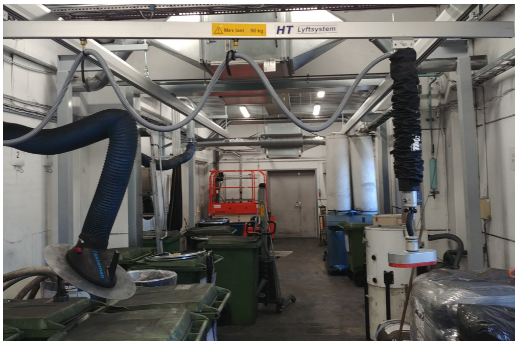
Skensystem med en enkeltravers och en vakuumslanglyft placerat i stålgalgar.
